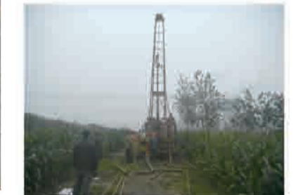
项目名称：徐州城市地质调查 工作内容：南许阳钻探施工 工作人员：刘正疆
