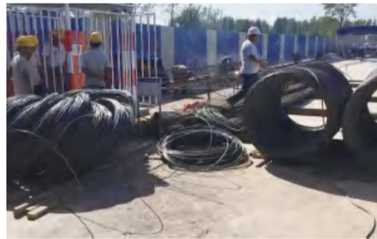
施工现场物料堆积混乱
