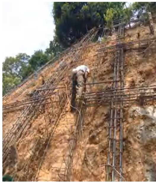
高空作业未佩戴安全带
