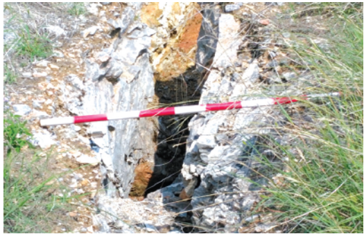
某山体坡顶拉张裂隙
